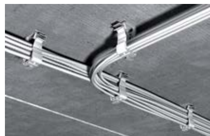
Крепление пучков кабелей
